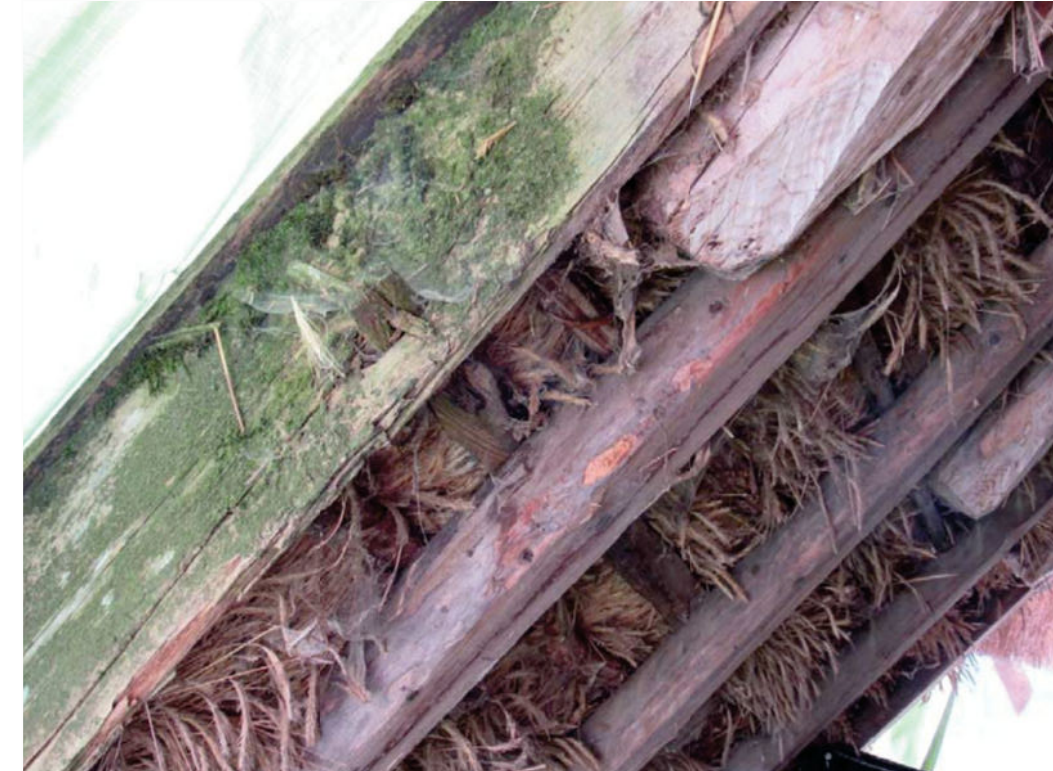
Detail Dachaufbau => an der Nordseite sind morsche Holzteile auszutauschen
